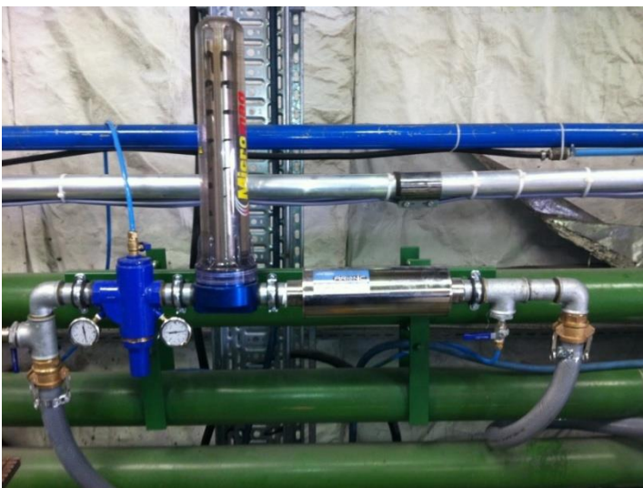
Appareil de 7,5 m 3 /h avec système de filtration adaptée en bypass sur la boucle de refroidissement
