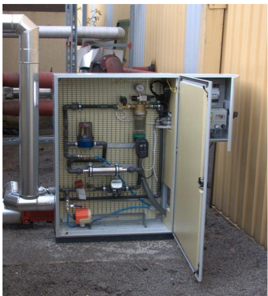
ARMOIRE DE TRAITEMENT ECOTEC 03
